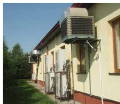
Restauracja „BASTA” Kutno - wykonanie instalacji „MODIUM”
